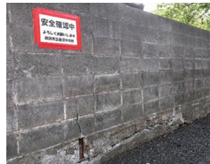
金沢中学校外周のブロック塀
