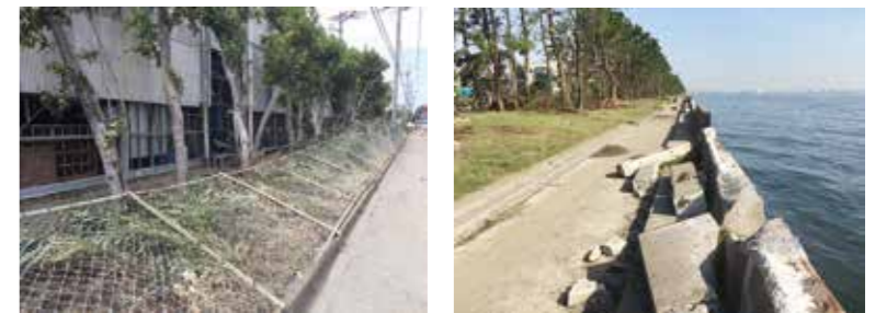
▲被災した事業所の建屋 ▲高波で破壊された護岸
