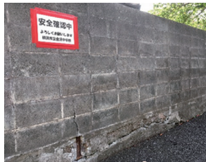
金沢中学校外周のブロック塀
