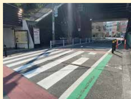
▲横断歩道の再塗装+赤色線を追加してクルマからの視認性を向上
