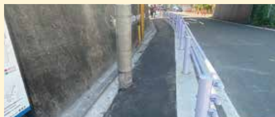
▲ガードパイプの隙間を無くす+歩道の拡幅 = 歩行者の飛び出しを防止
