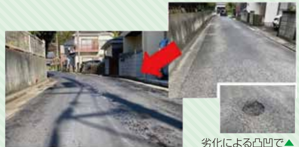
劣化による凸凹で▲大きな陥没も
